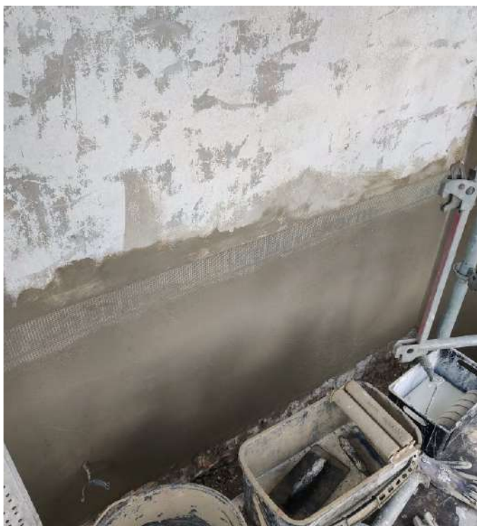
Efter færdiggørelse af pudsreparationer blev alle flader inklusiv gesimser påført glasfiber-net i våd puds og efterbehandlet "vådt i vådt"
