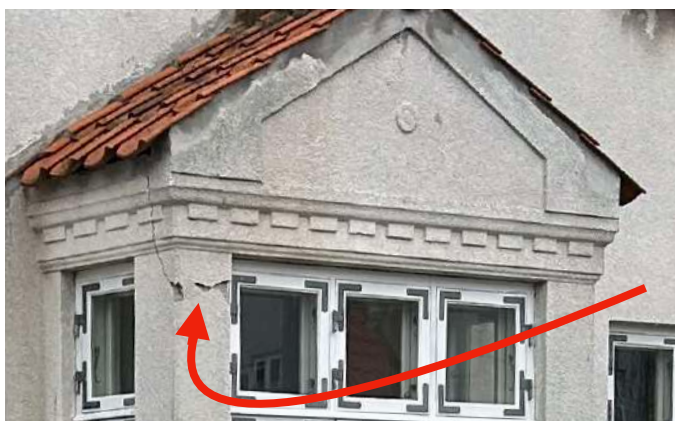
Før renovering, revner ses i venstre side af karnappen
