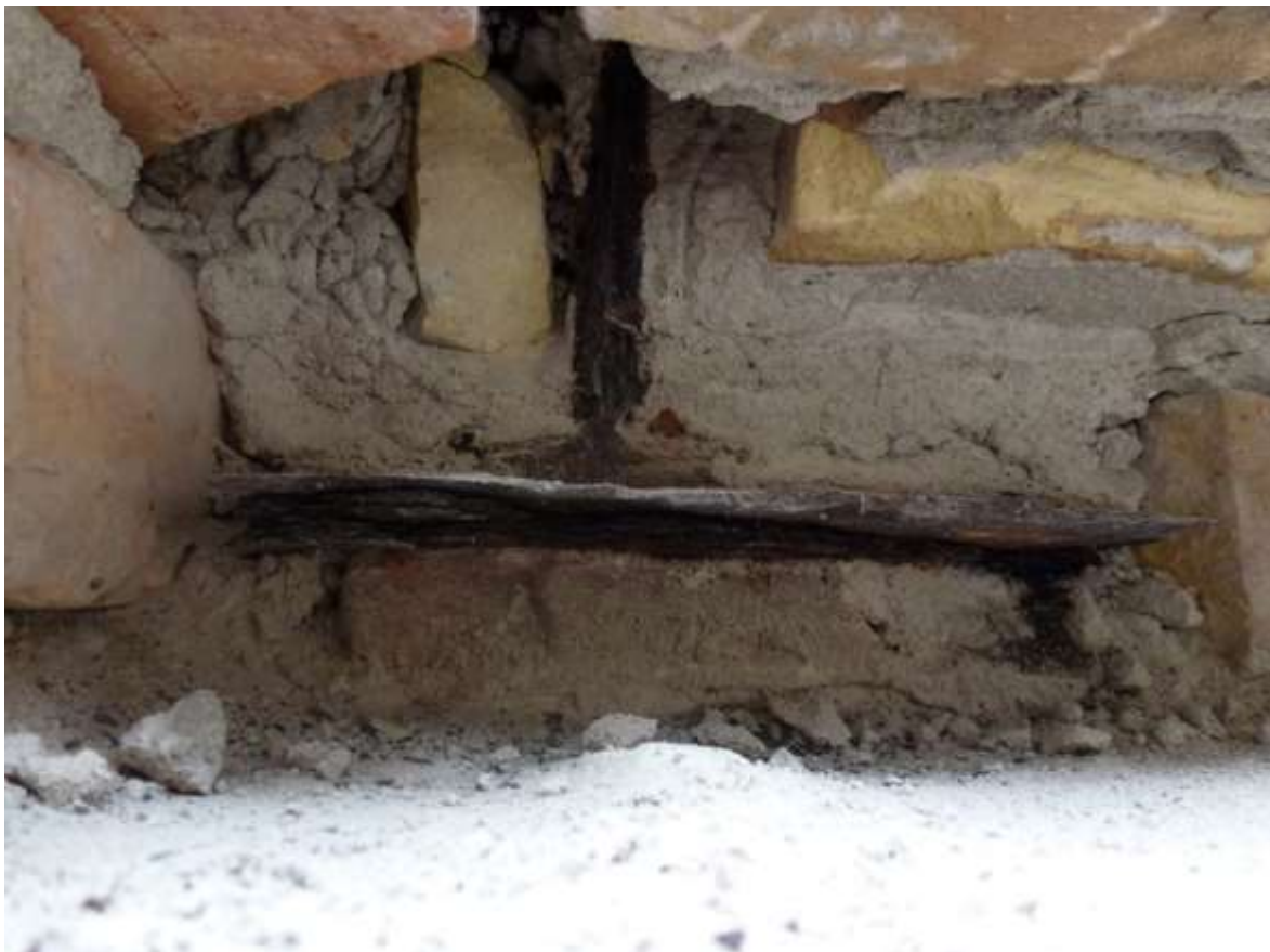
Foto: Mursten fjernet i mur over hoveddør. I-jern lodret øverst i billede bærer hovedtrappen. Hviler på opsoulmet vederlagsplade, der er blevet helt "lagdelt" pga. rustangreb (vandret nederst).
