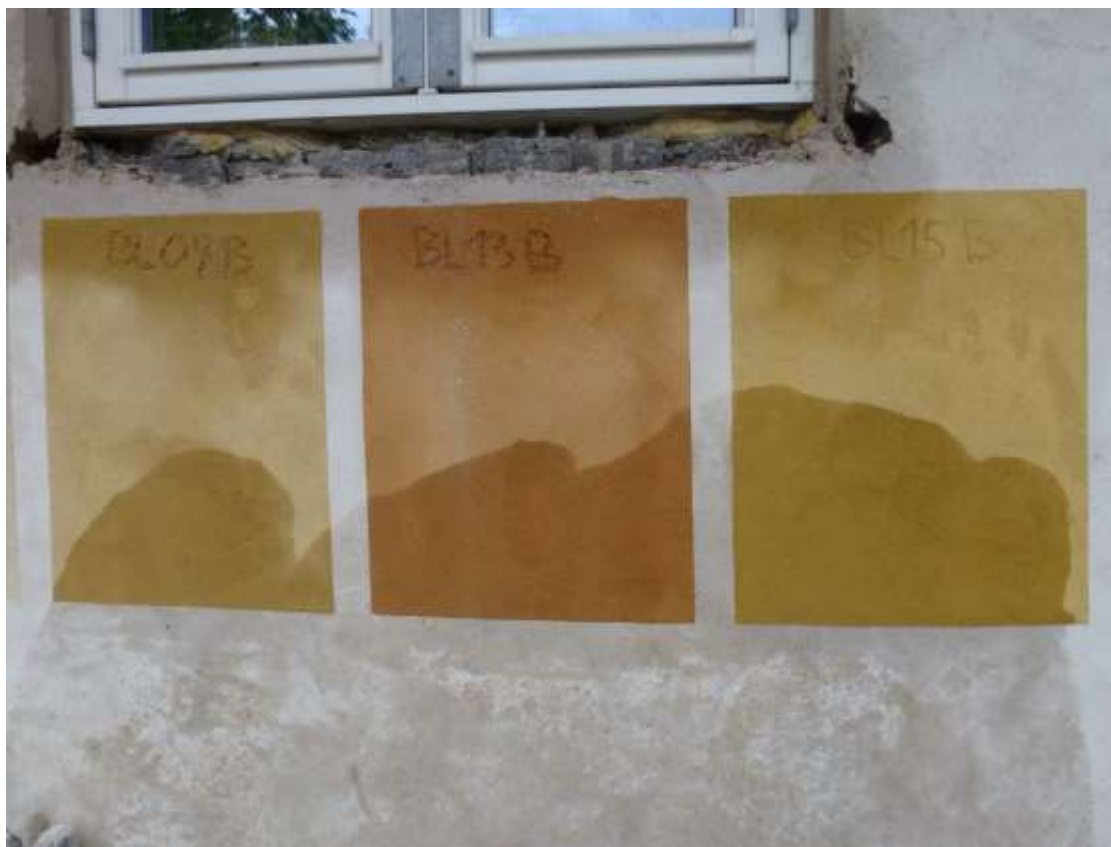
Foto: Farveprøver afsat på mellemste grove pudslag. Vædet op forinden for at få indtryk af farvespillet i tør og våd tilstand. Valgt oxidgul yderst til højre (BL15B).
