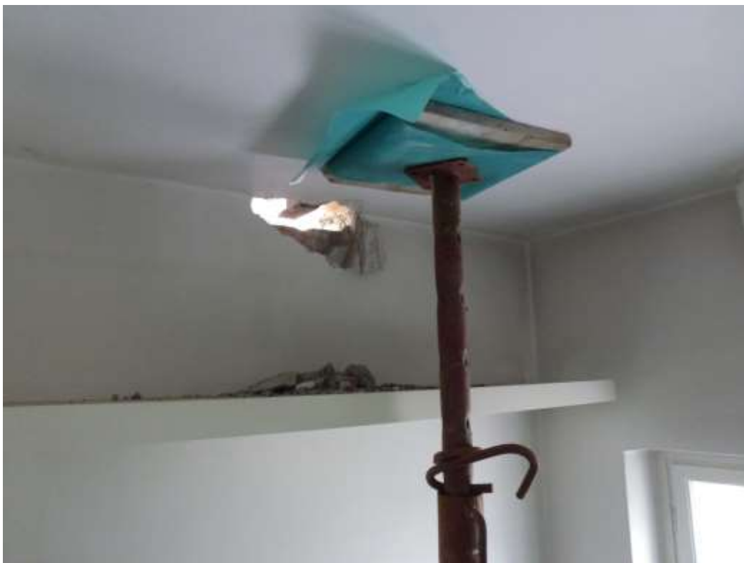
Foto: "Soldat" der bærer hovedtrappe under reparation. Bemærk I-jern, der stikker ud i hullet i murværket.
