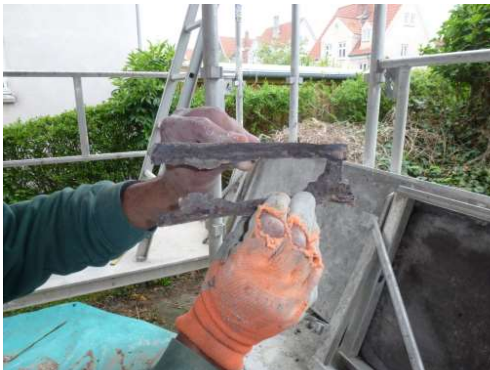
Foto: Rustne del af I-jern fra entrepladen. Faldet af ved frilæggelse
