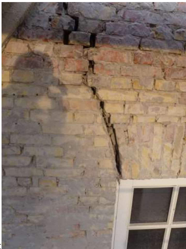
Foto: Reven over altandør. Bredden først tydelig efter at puds er skrællet
