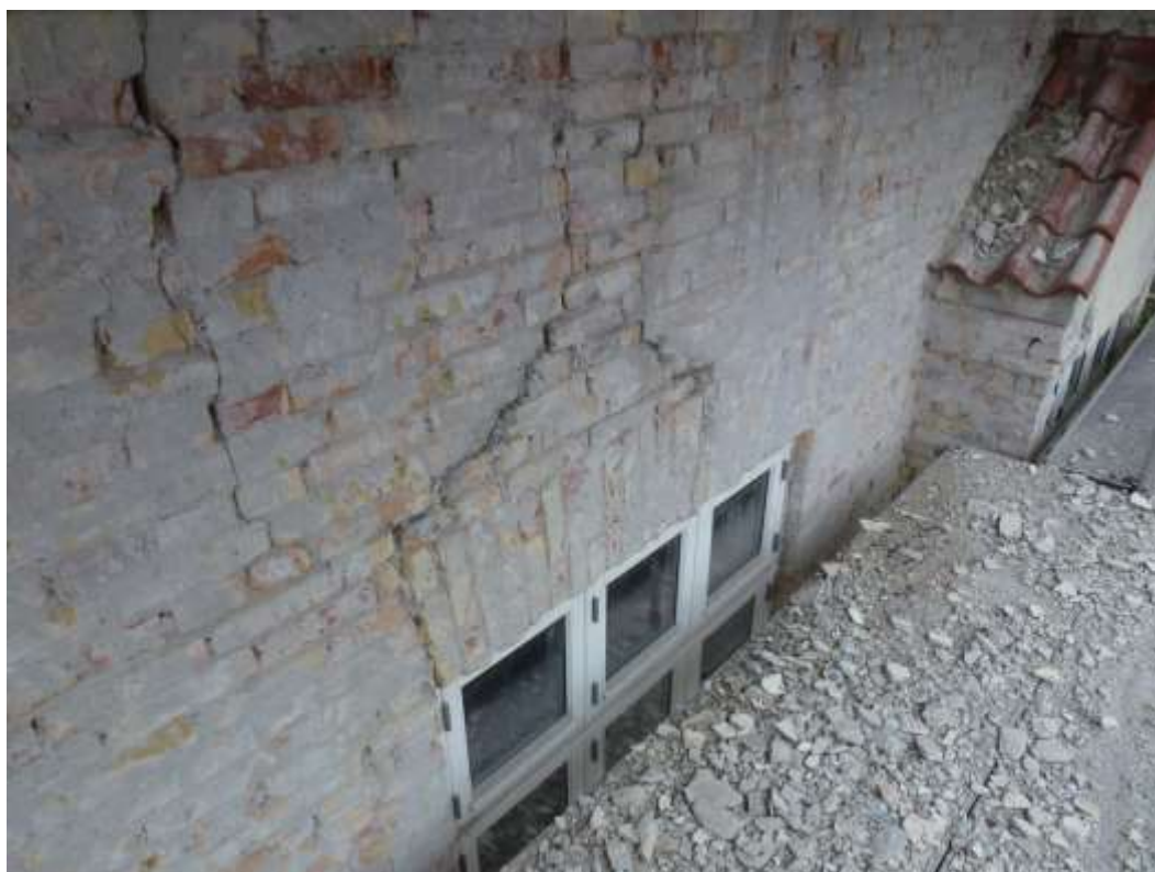
Foto: Murstenene over vinduerne er sunket i en samlet blok.
